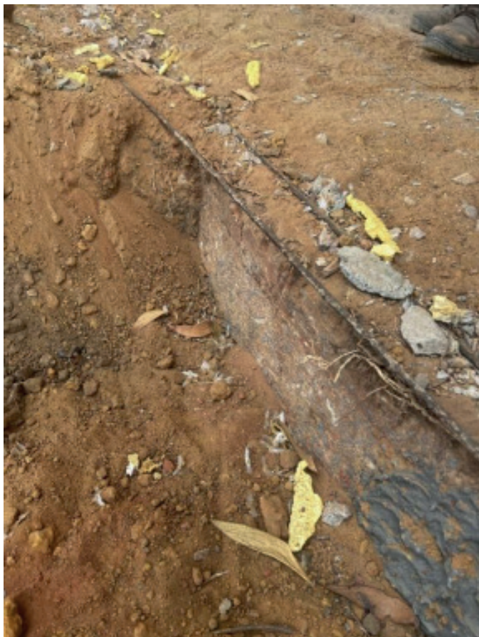
Figura 5: Autora, Viga de travamento com armadura exposta (2024)
