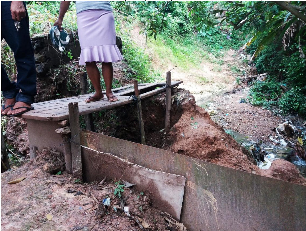
Foto 17: Acesso improvisado com pedaços de porta na rua São Pedro, Vila Embratel.
