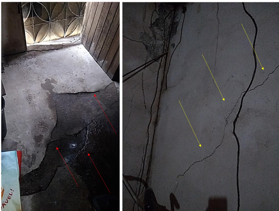
Fotos 23 e 24: Sinais de rachaduras e afundamento do solo.
