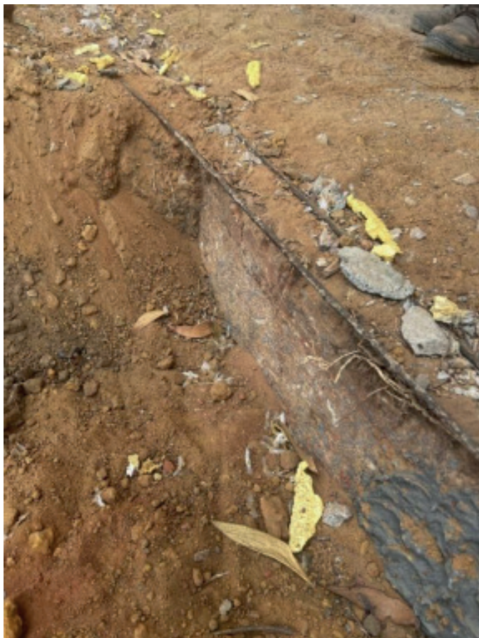
Figura 5: Autora, Viga de travamento com armadura exposta (2024)
