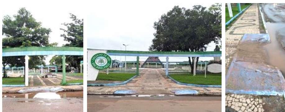
Figura 1 - Rampas Obstruídas na Praça Santa Terezinha.
