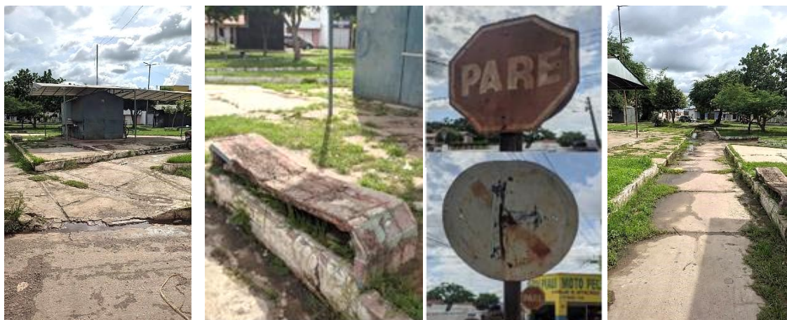
Figura 2 – Condições estruturais da Praça Bom Pastor, sinalização e acessos.
