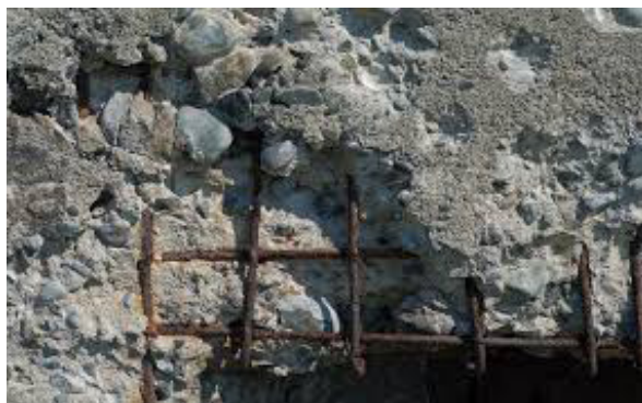
Figura 10 – Perda de aderência ou destacamento de revestimento
