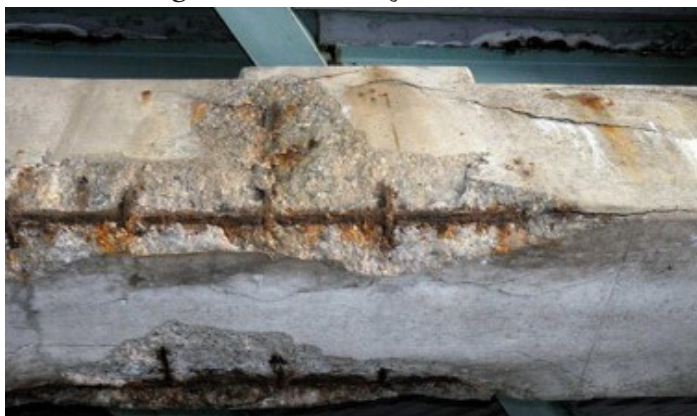
Figura 5 – Carbonatação de concreto
