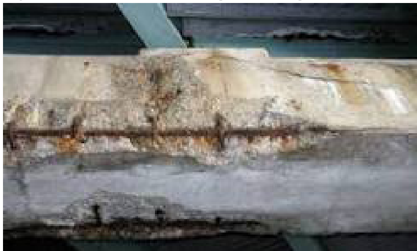
Figura 17 – Corrosão do concreto, deslocado consequentemente, e do aço
