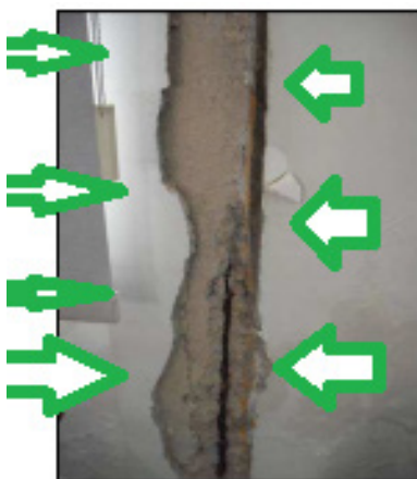
Figura 8 – Disgregação do concreto
