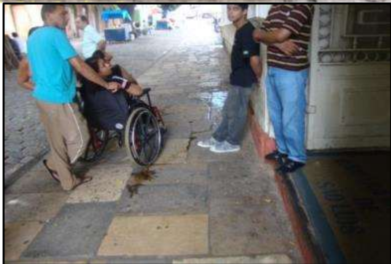
Foto 7: Entrada da câmara de vereadores com ausência de rampa/Barreiras nas edificações
