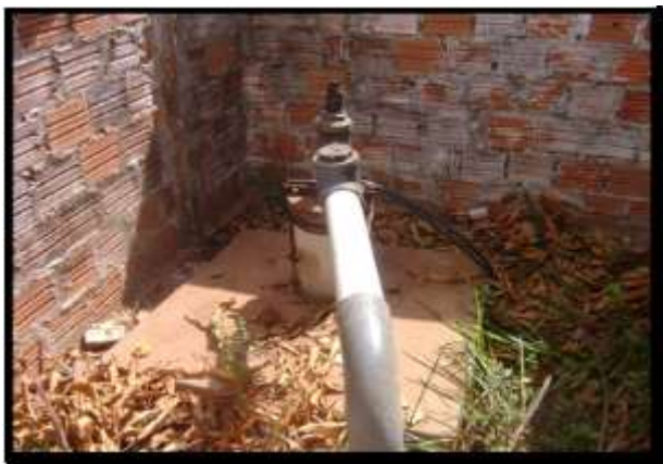
Foto 2: Poço tubular coletivo do Residencial 21 de abril. Fonte: Registro de pesquisa, 2011.
